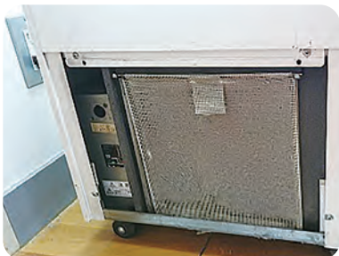
人工気象器の汚れ(凝縮器フィルタ)
